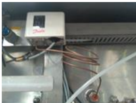
Figura 14 - Termostato da resistência de AR
