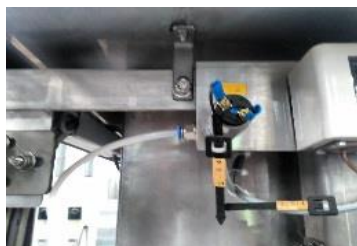
Figura 10 - Pressostato de AR nas canaletas
